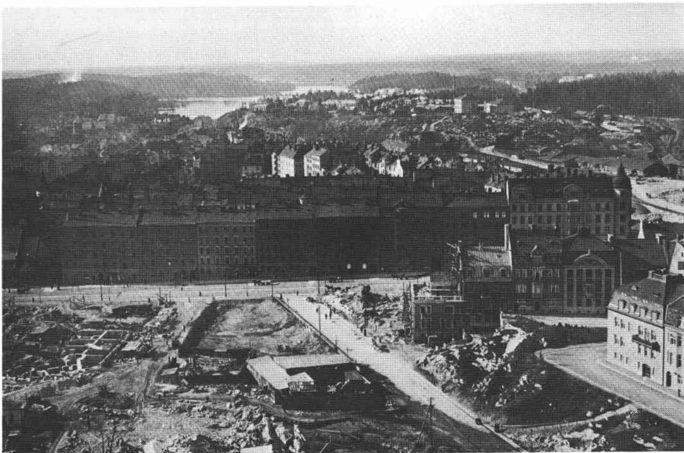
Utsikt mot nordväst från Engelbrektskyrkan 1912. Kvarteret Trasten vid Odengatan bildar fond till gatu- och grundläggningsarbeten i kvarteren Lövsångaren och Flugsnapparen, till höger pågår färdigställandet av husen vid Tyrgatan i kv Tofslärkan (jfr omslagets ritningar).
