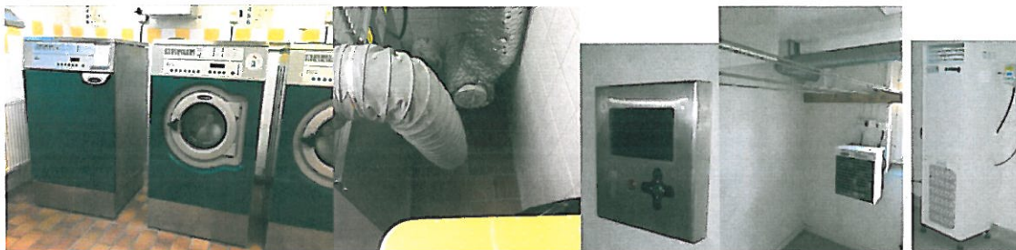
Tvättmaskin Och torktumlare Avluftskanal 90-grader. Tvätt bokning. Befintligt torkrum. Förslag på avfuktare
