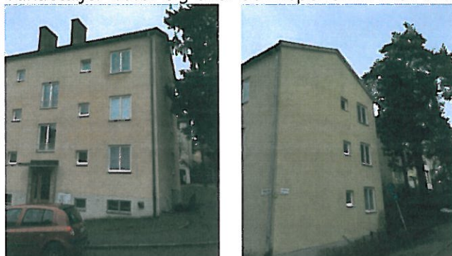
Vindskivor och stuprör är i behov av en underhåll.
