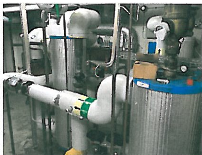
Fjärrvärmecentralen Skåpvägen 13, tappvarmvatten från år 1985, Värmesystemet från år 1994.
