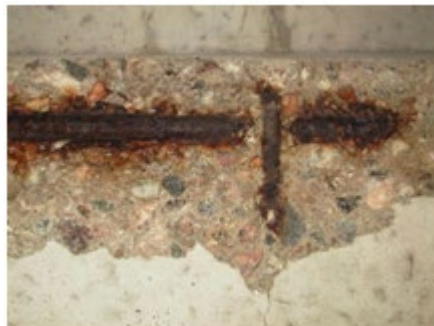
Exempel på skadad balkong. OBS! Annat objekt!
